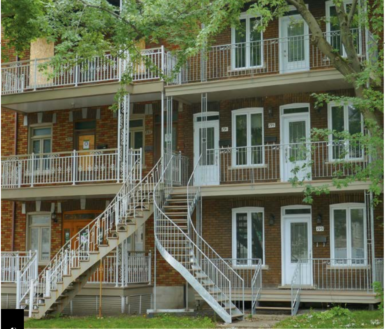
◀ Pour les personnes âgées, les escaliers deviennent des obstacles (arrondissement La Cité-Limoilou, Québec). Photo : Valérie Levée
